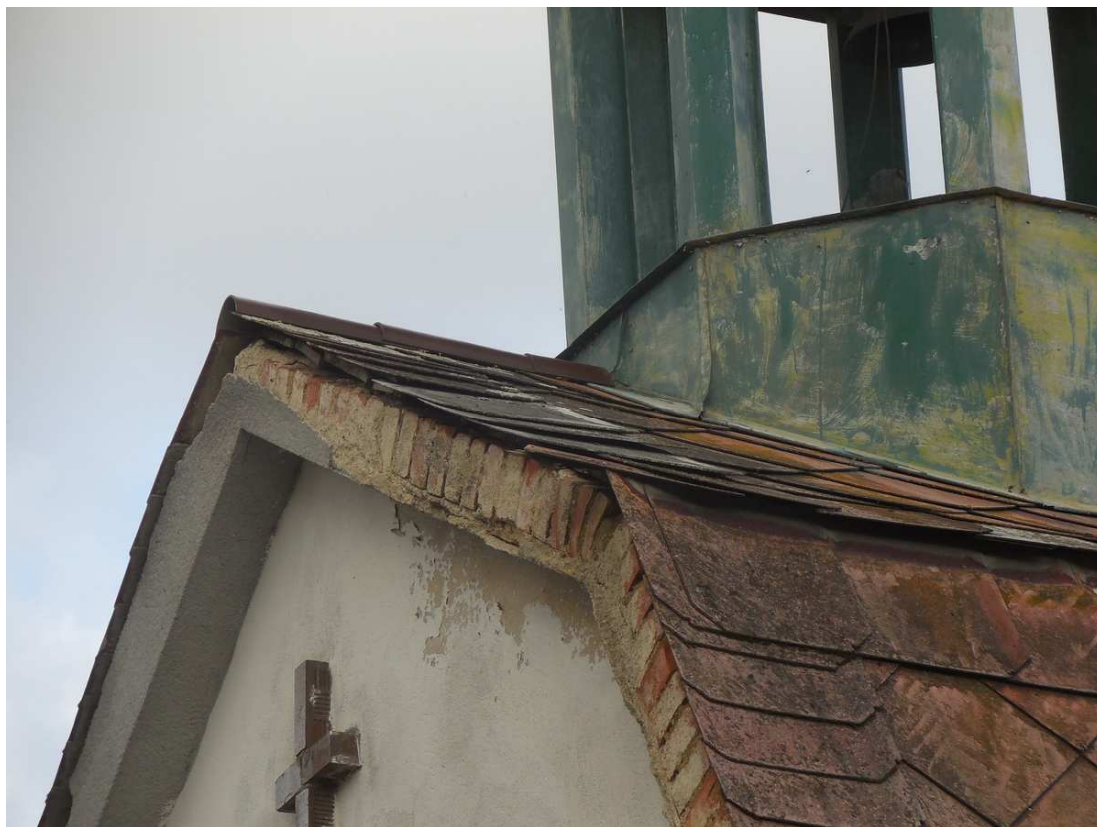
Stávající eternitová krytina - zlom
