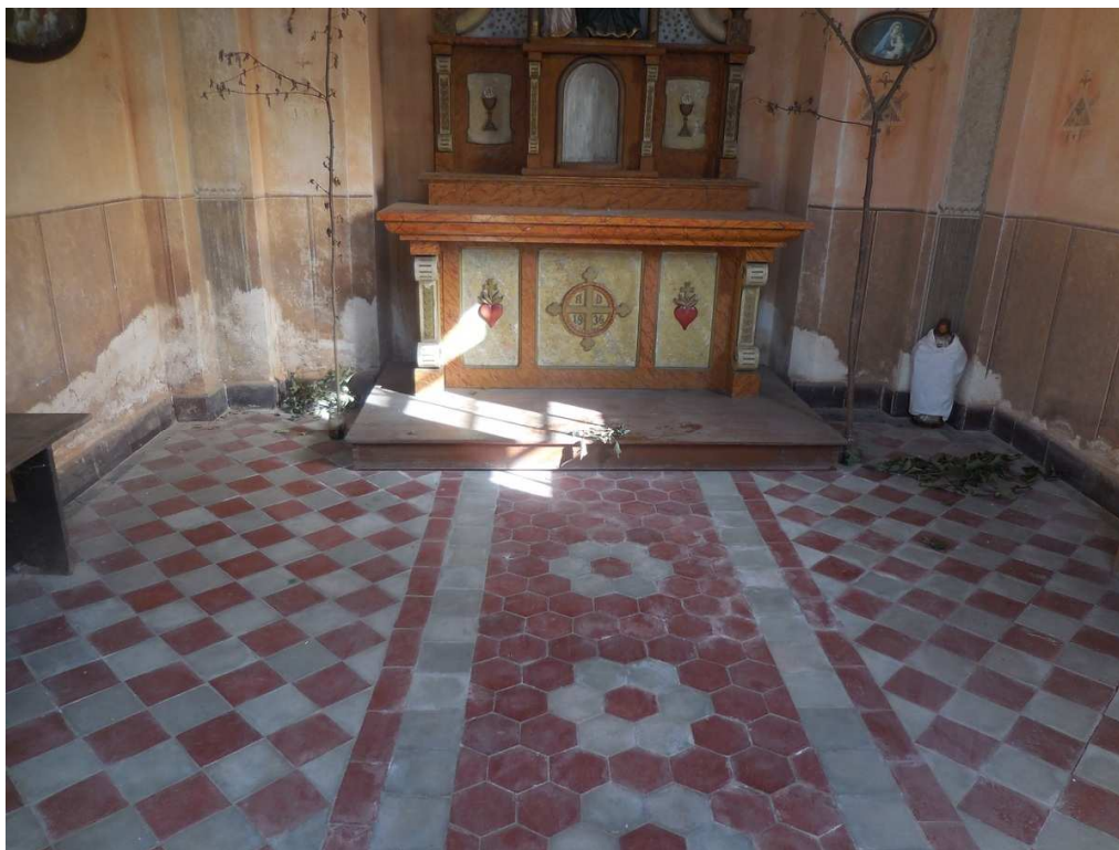
Stávající skladba dlažby uvnitř kaple – bude odborně vybourána a nahrazena skladbou novou. Stávající skladba dlažby velmi zvlněná, propadlá
