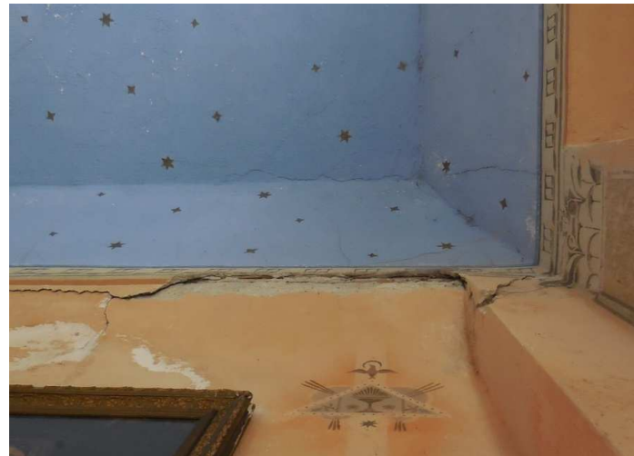
Poškození fabionů a šikmých ploch pod stropem
