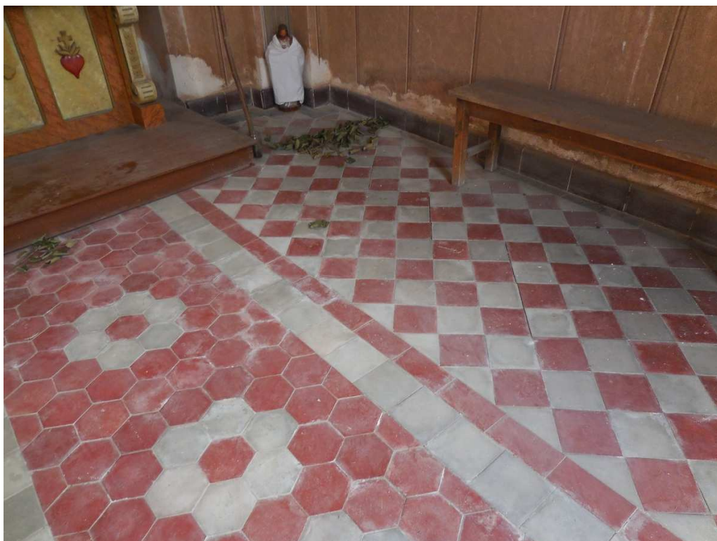
Stávající skladba dlažby uvnitř kaple – bude odborně vybourána a nahrazena skladbou novou. Stávající skladba dlažby velmi zvlněná, propadlá
